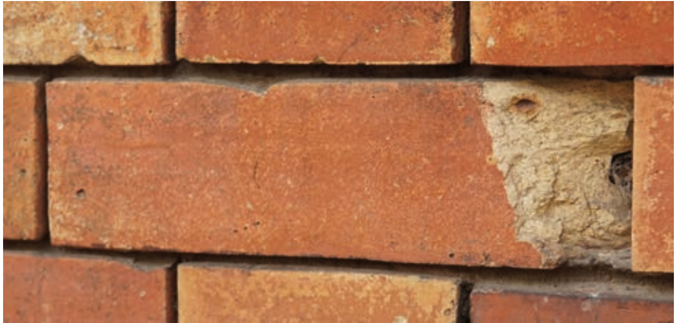
350 rechts Engobierter Ziegel aus dem Sockelbereich des Askanischen Gymnasium, Hermann Blankenstein, 1875, Berlin. Das gelbe Grundmaterial ist im Bereich des Sockels mit einer roten Engobe überzogen.
