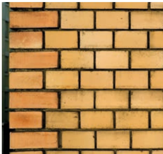
487 Farblich nicht genau auf das Verblendmaterial abgestimmte Dreiquartierecksteine in der Bremgartnerstrasse 59 in Zürich, 1894.
