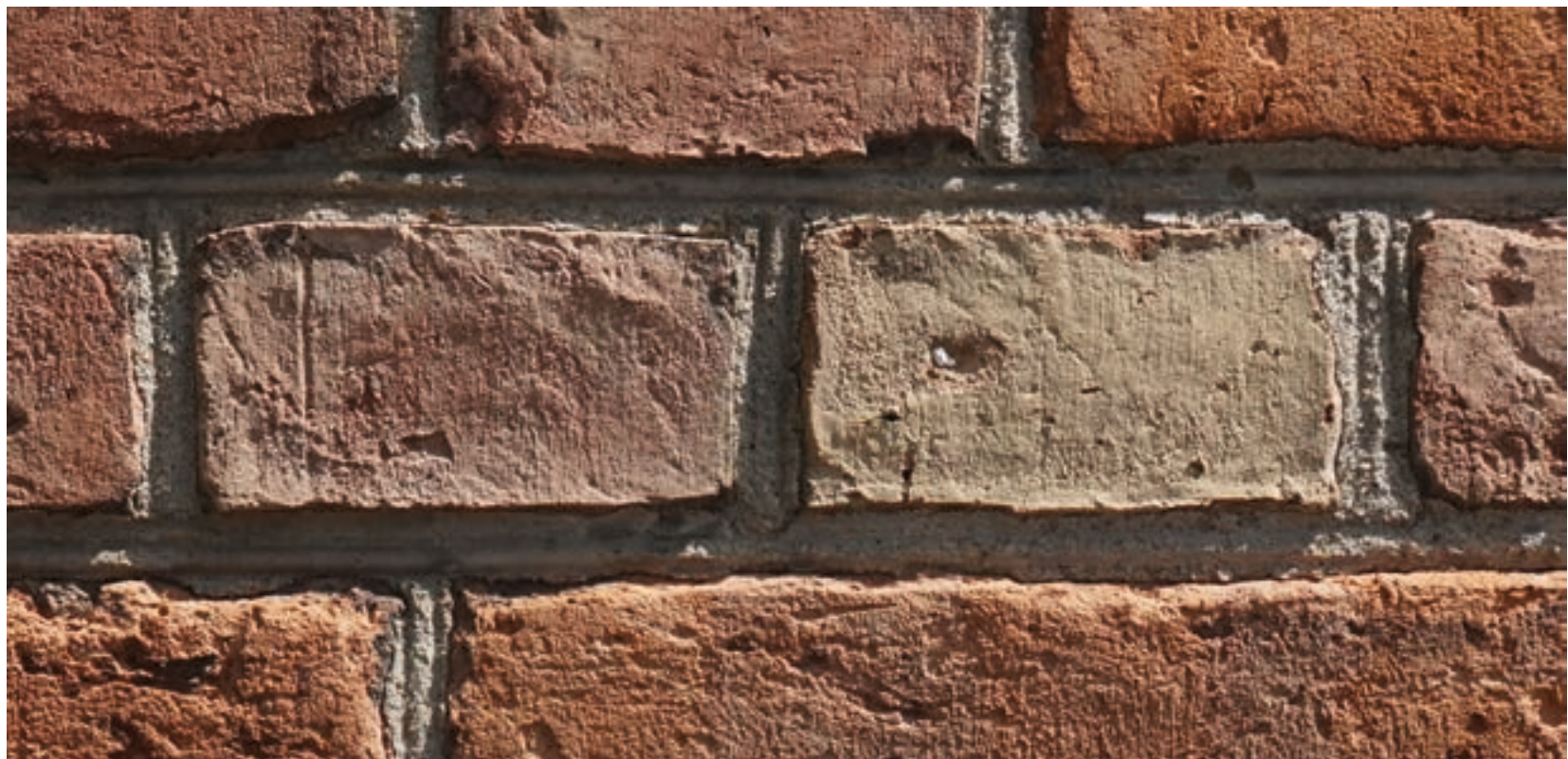
96 Detail zweier Binder der Nazarethkirche im Wedding: Schlieren des Wasserstrichs, Wulst und abgeschnittene Brahmkanten, beide Steine wurden auf dem Kopf stehend vermauert.
