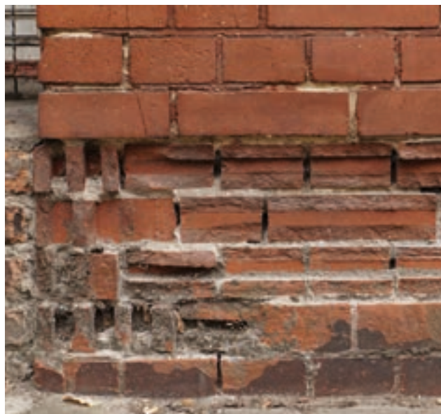
485 Einblick in die Ausbildung der Ecke an einem beschädigten Wandstück des Universitätsklinikums an der Ziegelstraße in Berlin. Gut sichtbar die horizontale Lochung des normalen Verblendmaterials und die vertikale Lochung der Ecksteine.
