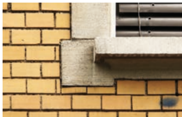
497 Zugeschnittene Plättchen im Bereich einer mangelhaft auf die Backsteinmaße abgestimmten Sohlbank. Zürich, Zeunerstrasse 11, 1907.
