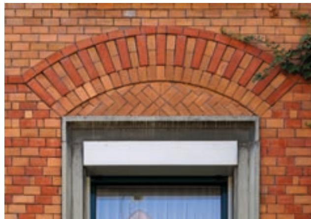
495 In der Verblendschicht betonter Entlastungsbogen über dem Fenstersturz aus Werkstein. Zürich, Sandstrasse 2, 1897.
