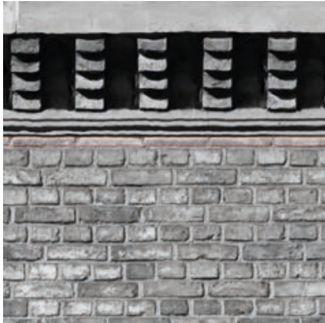
438 Ausschnitt eines Orthofotos der Nazarethkirche in Berlin: Unterhalb der Konsole ist eine Lage aus nur etwa halbhoher Ziegeln eingefügt, was zeigt, dass die Gesamthöhe der Fassade nicht auf das Ziegelmaß abgestimmt wurde.
