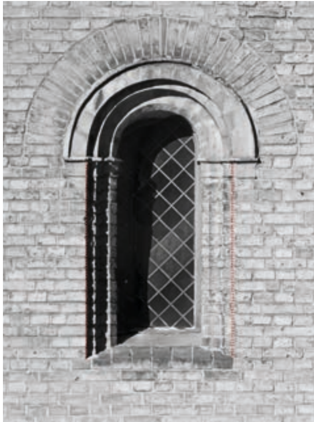
440 Ausschnitt eines Orthofotos der Nazarethkirche in Berlin: Das Öffnungsmaß der Fenster wurde nicht aus dem Backsteinmodul entwickelt, weshalb die linke Laibung nicht korrekt im Verband aufgeht und es im näheren Bereich zu Verschmierungen kommt.
