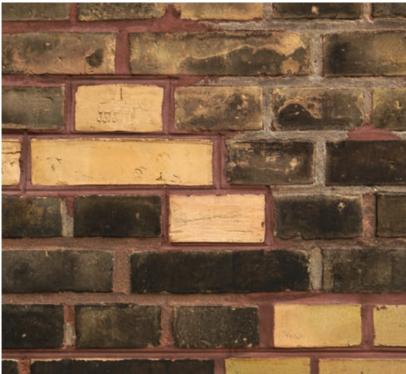
548 Fassadenausschnitt der Zionskirche, Orth, 1866-1873. Diverse Ziegel wurden offensichtlich in letzter Zeit ausgetauscht und auch die Fugen entstammen allein in diesem Ausschnitt mindestens drei verschiedenen Bau- beziehungsweise Sanierungsphasen.
