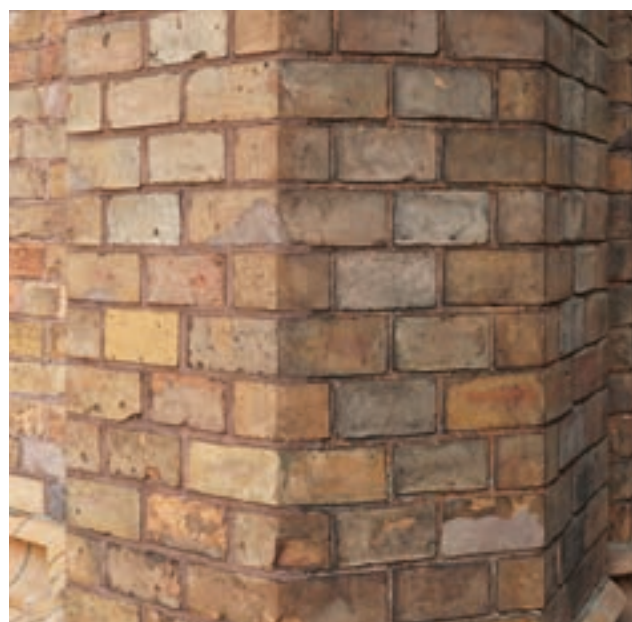
480 135°-Ecken an einem oktogonalen Pfeiler der Bartholomäuskirche in Berlin. Auch hier kamen zwei unterschiedliche Sondersteine mit gleichlangen Schenkeln zum Einsatz, allerdings in den Längen von 1/2- und 1/4-Stein.
