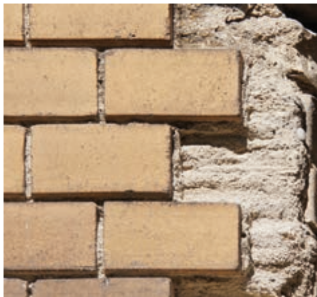
540 Fugenausbildung bei einer Plättchenfassade an der Zentralstrasse 72–78 in Zürich, 1911. Die Plättchen wurden in den Versatzmörtel gedrückt, der gleichzeitig das Fugenmaterial darstellte.
