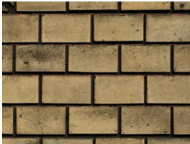
425 Detail der Fassade des Westflügels des Naturkundemuseums in Berlin (1883–1889). Man erkennt gut, dass die etwas unterschiedlichen Steinhöhen beim Mauern an der Oberkante ausgerichtet wurden.
