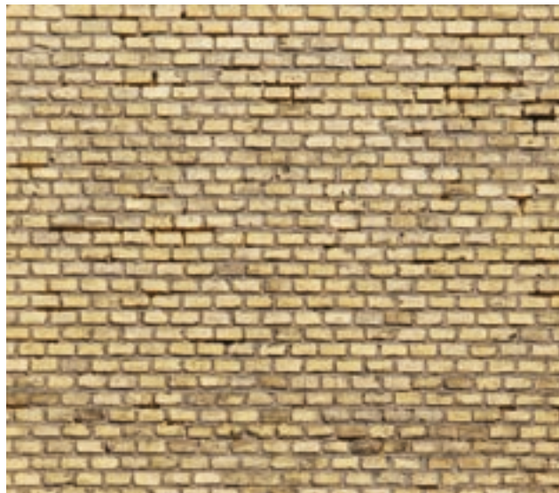
458 Großflächig eingesetzter Binderverband an der Stresow-Kaserne in Spandau, ausgeführt durch Fleischinger, 1860–1862. An einer Fehlstelle ist sichtbar, dass die äußere Fassade-schicht nur \frac{1}{2} -Stein breit ist. Dahinter liegt eine \frac{1}{4} -Stein breite Luftschicht.
