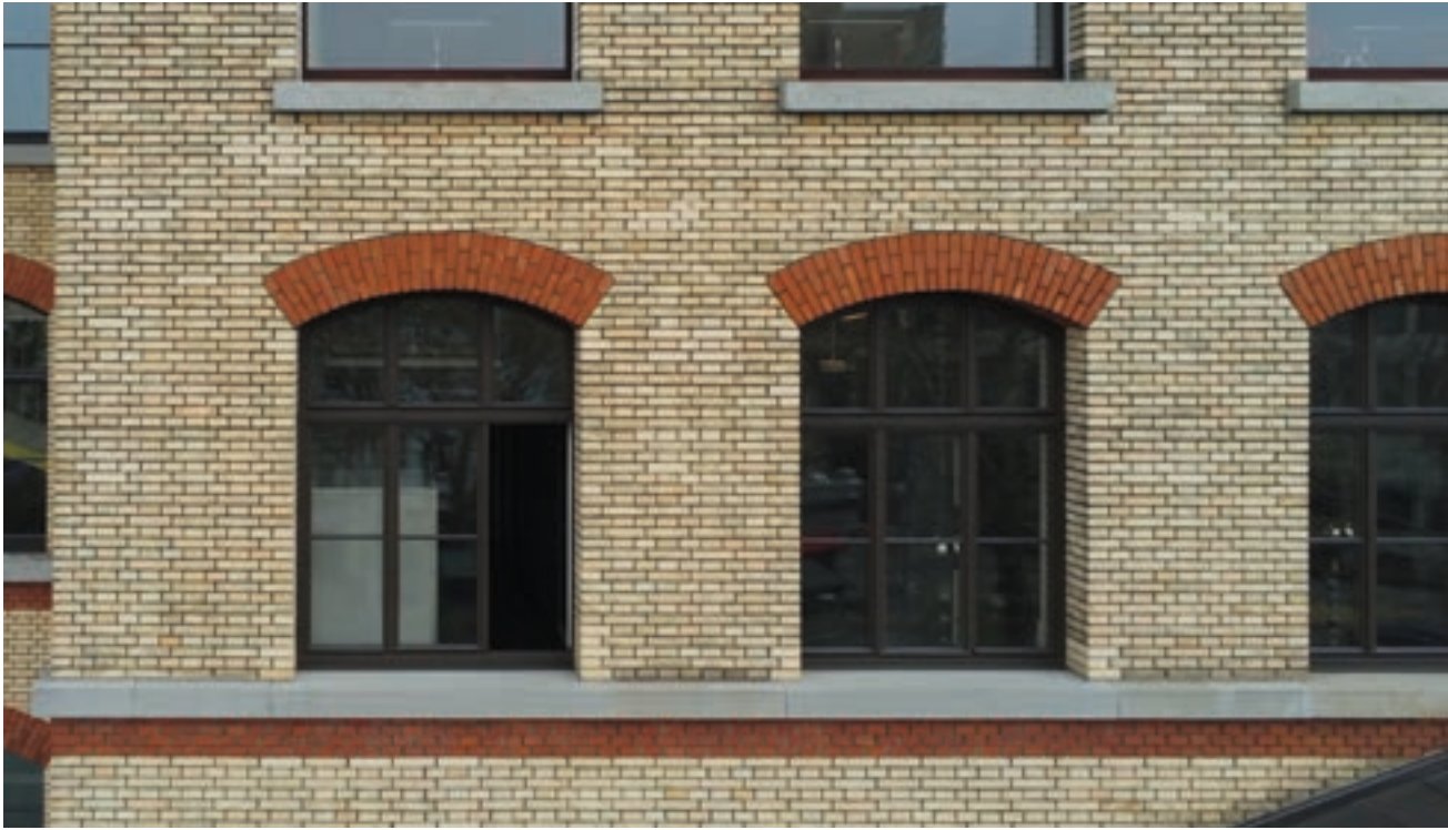
449 Fotografie der zwei linken Fenster im zweiten Obergeschoss oberhalb des durchlaufenden Werksteingesimses. Der Pfeiler zwischen den Fenstern ist fälschlicherweise mit einer Binderlage anstelle einer Läuferlage begonnen worden, weshalb es zwischen den roten Bögen zur Anpassung kommen musste, indem zwei Binderschichten direkt aufeinander folgen und der Blockverband an dieser Stelle ignoriert werden musste.
