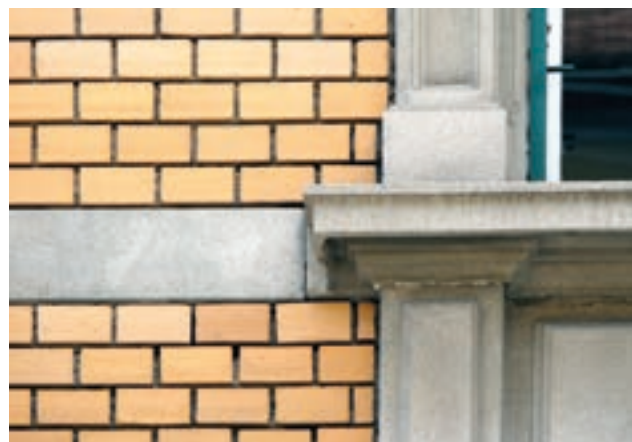
496 Der eigentliche Fensteranschluss ist relativ sauber in den Backsteinverband eingeführt, das Postament jedoch nicht auf die Fugenlage abgestimmt. Zürich, Kanzleistrasse 109, 1899.
