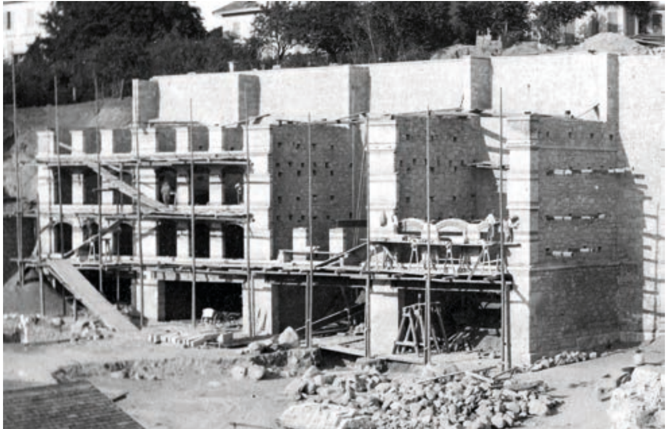
400 Fassade aus vollformatigen Backsteinen vor einer Konstruktion aus Bruchstein. Baustelle an der Waldmannstrasse in Zürich, Mitte der 1880er-Jahre.
