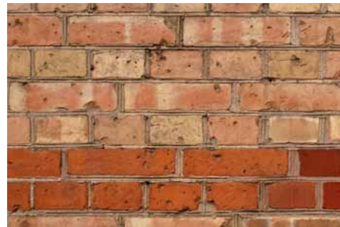
Abb. 9b Berlin, St.-Matthäus. Fassadenausschnitt mit teilweise ersetzttem Steinmaterial und überarbeiteten Fugen
