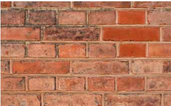
Abb. 5a Berlin, Friedrich-Werdersche Kirche. Fassadenausschnitt mit teilweise ersetzttem Steinmaterial und überarbeiteten Fugen
