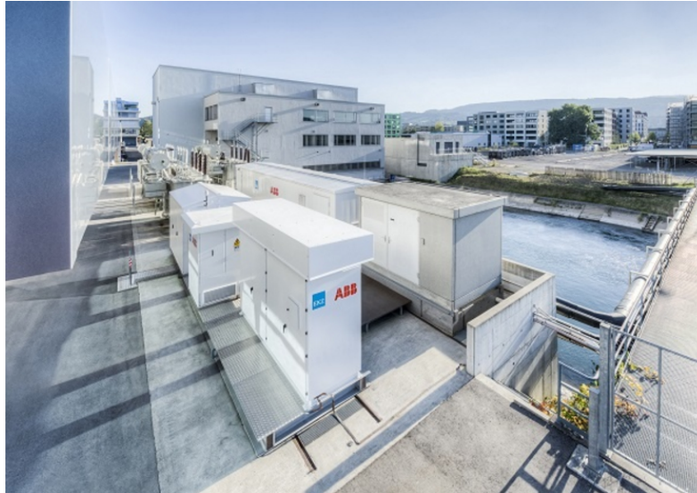
Abbildung 9: Energiespeichersystem in Dietikon im Kanton Zürich
