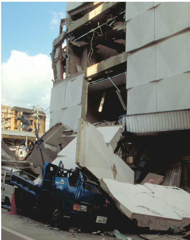
Abb. 2: Heruntergestürzte schwere Fassadenplatten beim Erdbeben von Kobe, Japan 1995
