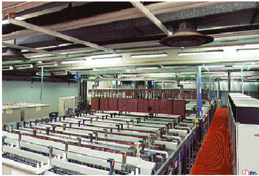
Bild (B027besZ) Grosse Galvanikanlage (Ludy)
