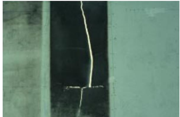
Abbildung D76 Wand 3 nach dem Brandversuch
