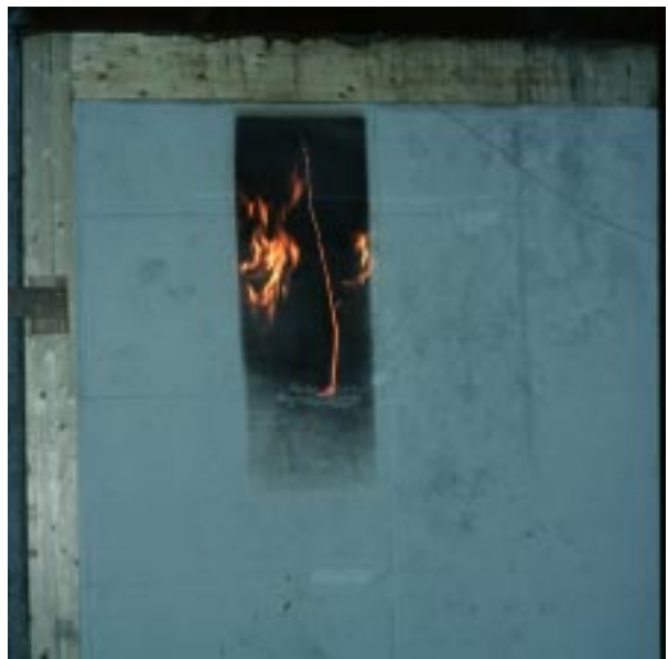
Abbildung D72 Foto Nr. 17 nach 71 Min.: Durchbrand durch Fermacell- platte (5)
