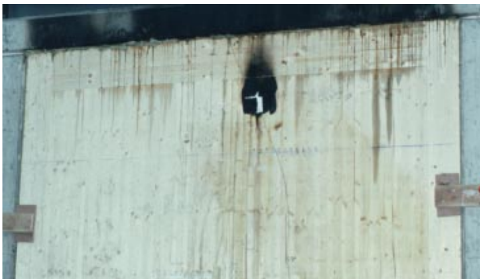
Abbildung 21 Durchbrand durch die Wand 2 nach 80 Minuten
