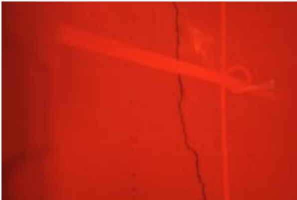
Abbildung D99 Foto Nr. 20 nach 80 Min.: Riss in Fermacellplatte (5) oben Mitte links
