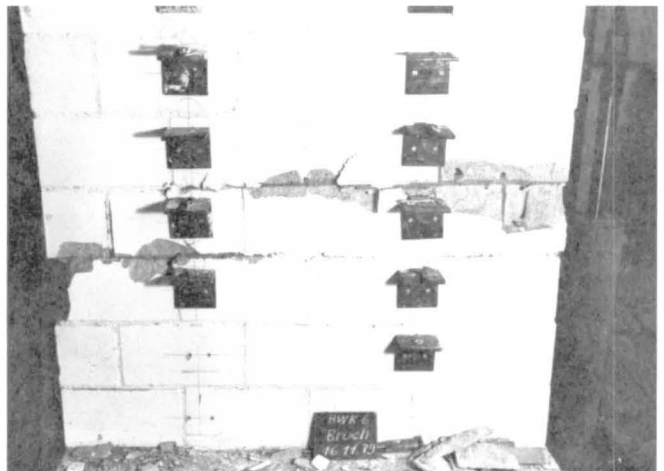
b) Starke Abplatzungen
