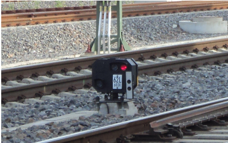
Abbildung 8.8 Deutsches Sperrsignal in Bauform eines Zwergsignals
